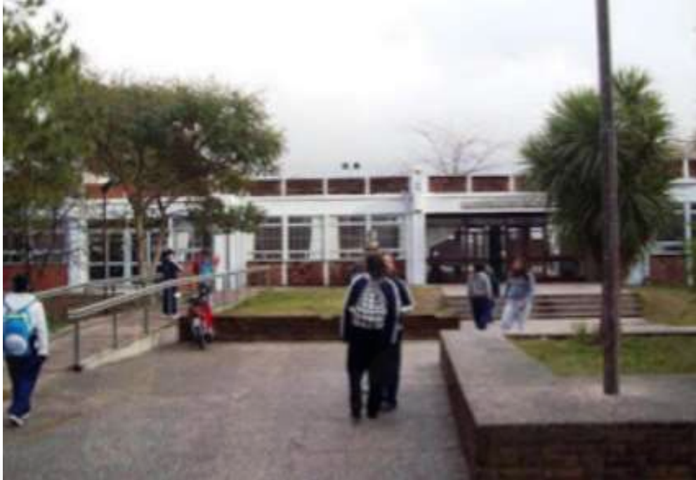
Dirección, baños y sala de profesores afectados por agua de lluvia
